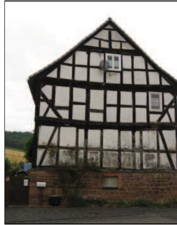
Wohngebäude mit Sanierungsbedarf
